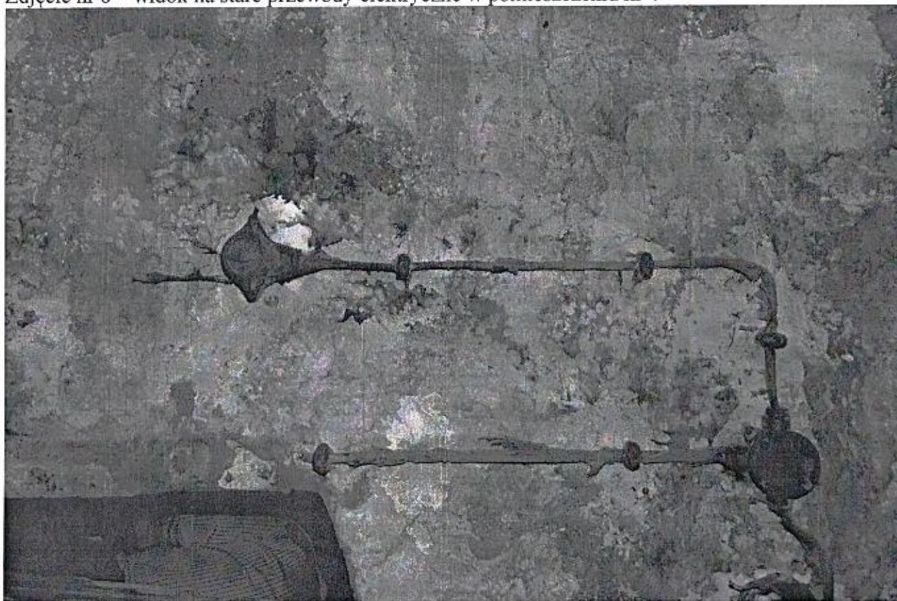
Zdjęcie nr 8 – widok na stare przewody elektryczne w pomieszczeniu nr 4
