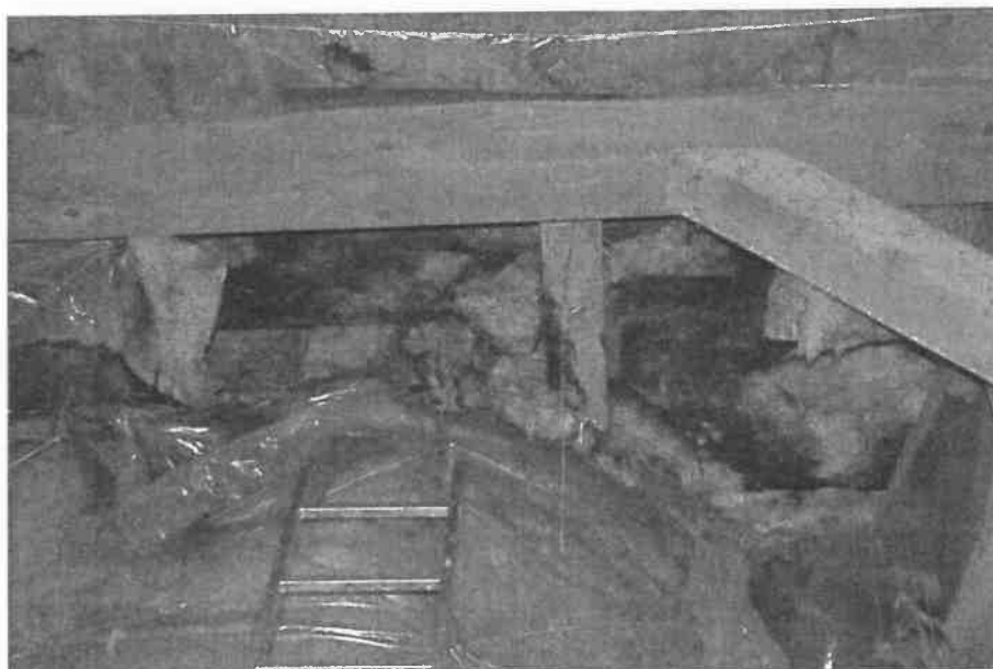
Rys. 10. Widok uszkodzeń poszycia dachowego
