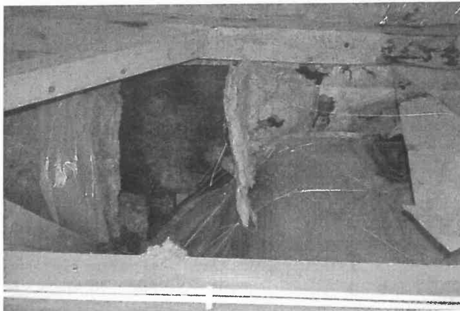
Rys. 9. Widok uszkodzeń poszycia dachowego
