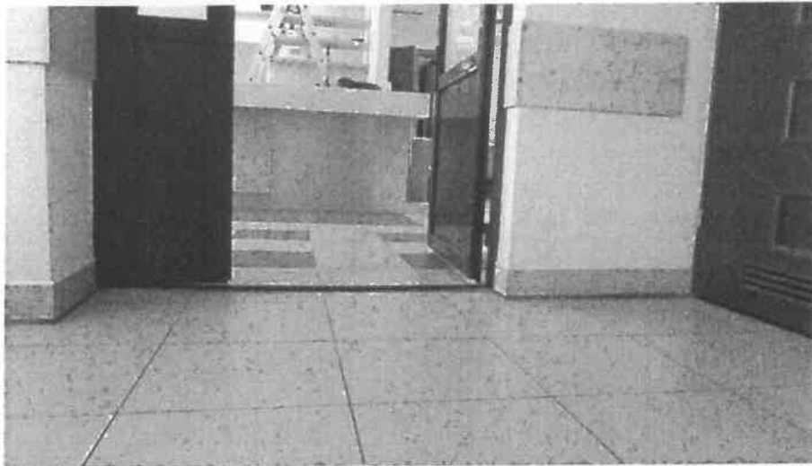
Rys. 5. Deformacja ościeży drzwiowych między osiami D-E/2, poziom +3,71m.
